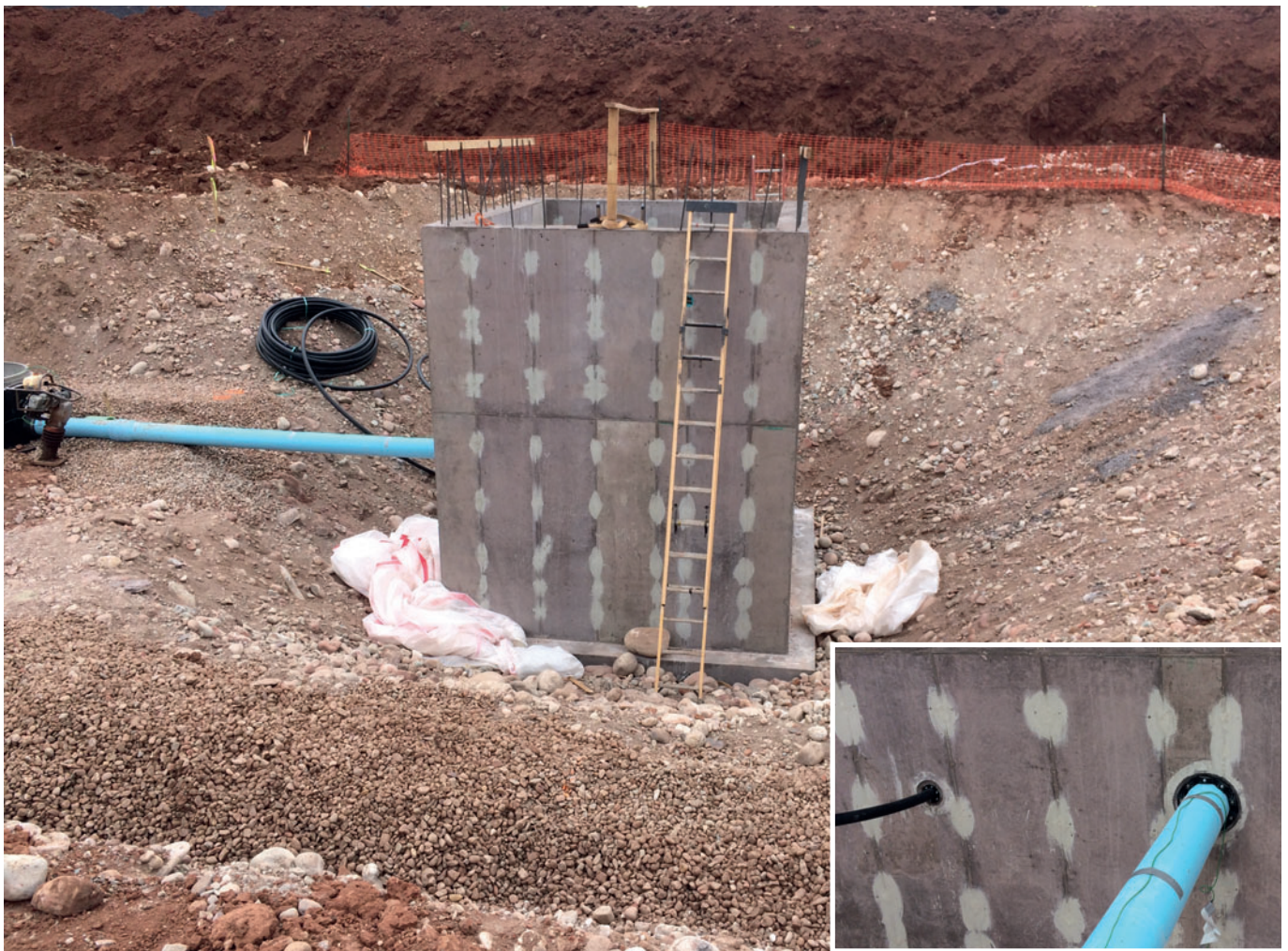
Fig. 4: La nueva estación de bombeo de hormigón in situ forma parte de la canalización para la ampliación del exclusivo Club Fork en Basalt, en el estado de Colorado, EE.UU. Al hormigón preparado para la nueva estación de bombeo se le añadió Xypex Bio-San C500, una impermeabilización cristalina y un aditivo antimicrobiano. A la derecha se observa un conducto de alimentación de 8 pulgadas (véase foto pequeña) hacia la estación de bombeo y a la izquierda un conducto de desagüe de 2 pulgadas.
