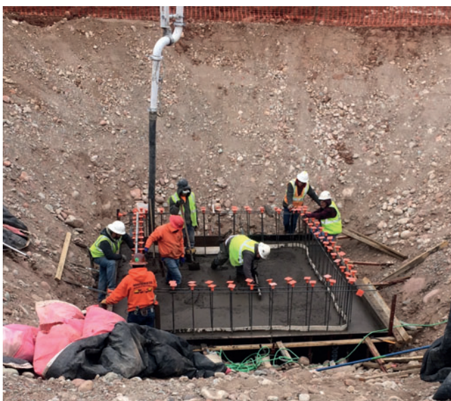
Fig. 5: Para la nueva estación de bombeo se hormigonó una losa con un espesor de aproximadamente 45 cm.
